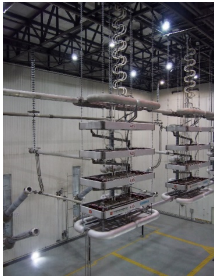
Fig. 2. 800kV UHV converter valve
